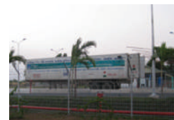
天然ガス供給設備
