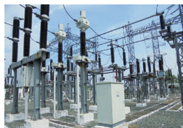
敷地内変電所
